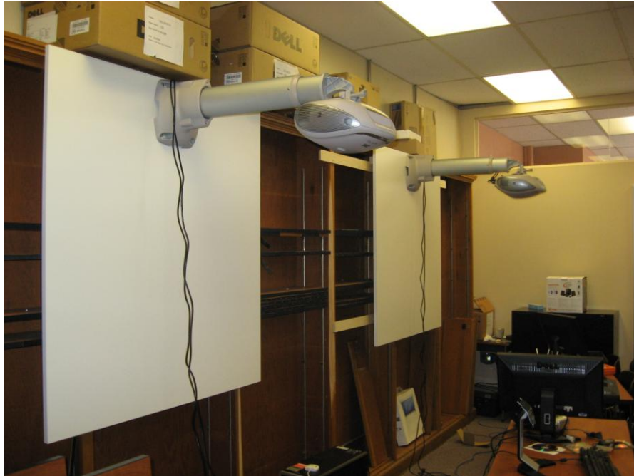
Figura 10.3 Instalación de los Projectores
