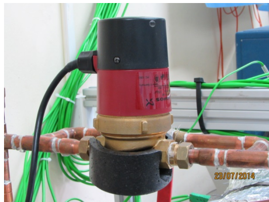
Fig. 3-18. Bomba de agua
