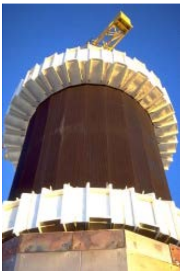
Fig. 1-21. Primer plano del receptor Solar Two (fuente: [43])
