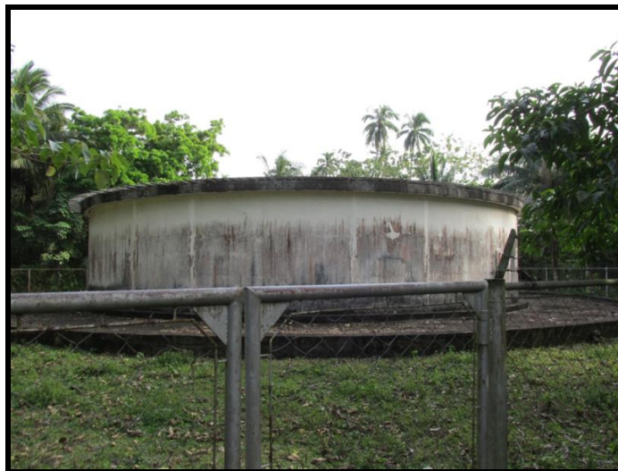
Figura 27. Tanque de agua de SAIL en San Pedro. Fuente: elaboración propia
