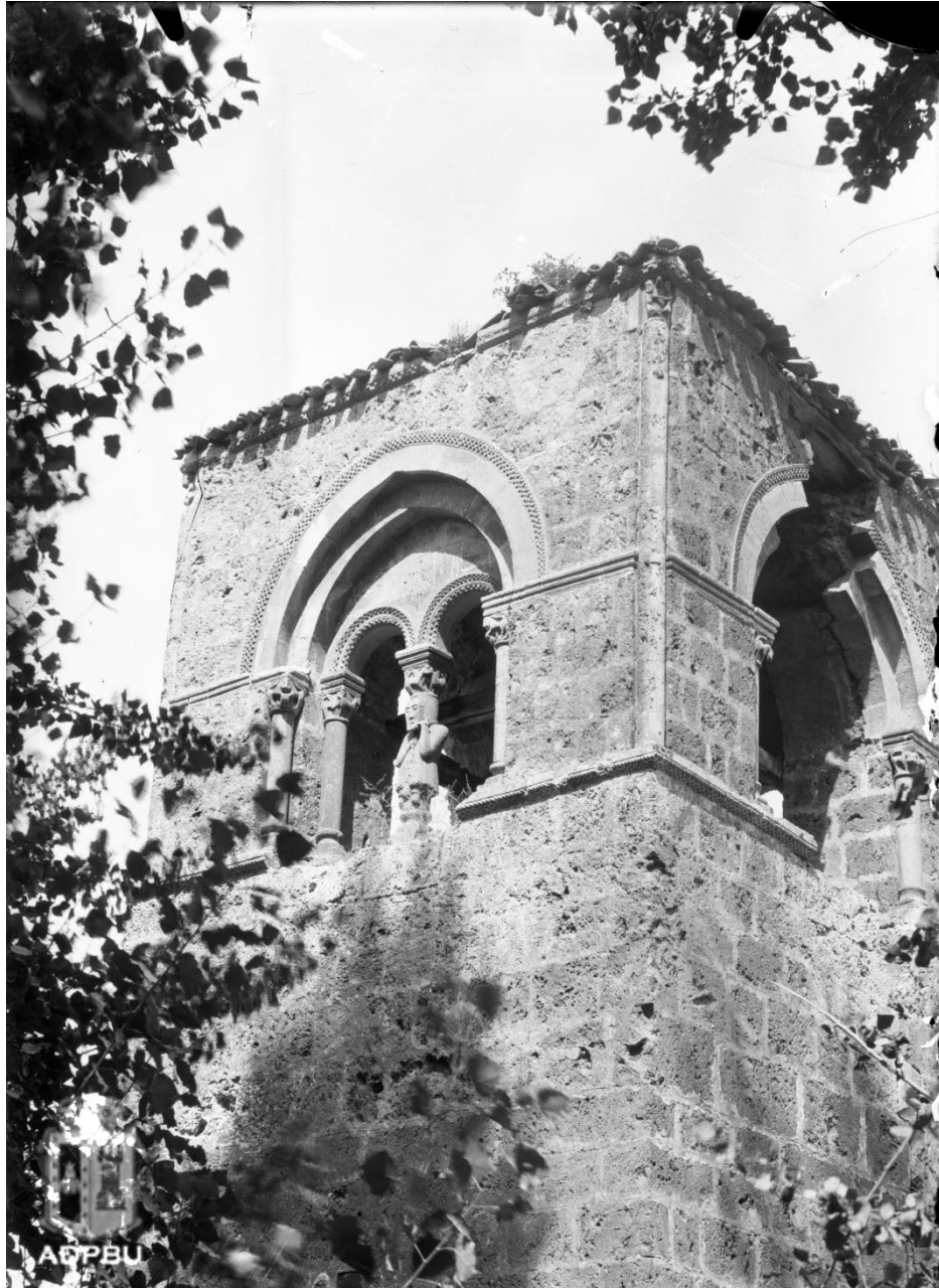
Lámina 13: Torre de la iglesia de San Miguel, de Tubilla del Agua 1141 , antes de su desmoche 1142 (fotografía sin autor preciso, realizada en el siglo XX 1143 )
