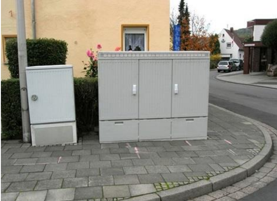
Figura 6: Armario de intemperie con equipo ADSL en una calle de Alemania. Fuente: Wikimedia Commons.
