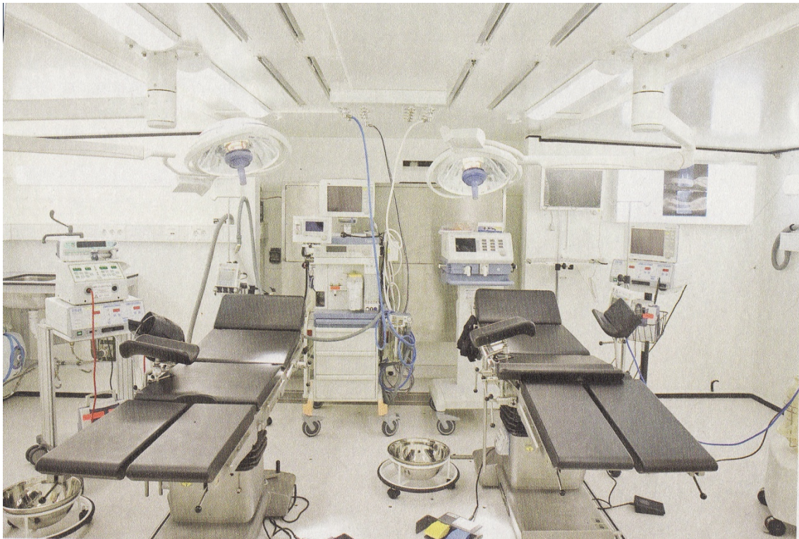
Figura nº 22 Quirófono del nuevo hospital de campaña español
